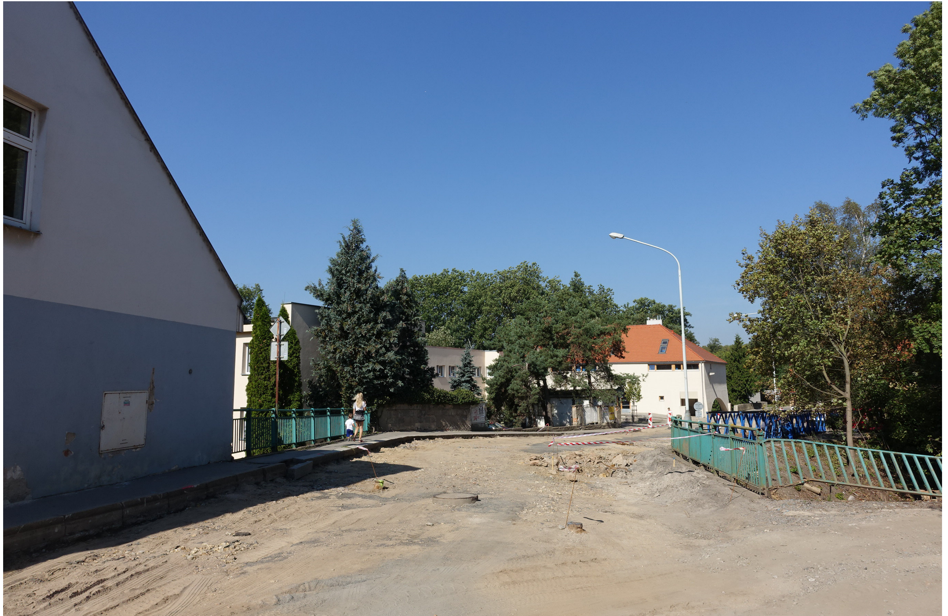
F,G SOUČASNÝ STAV CHODNÍKŮ, ZTÍSNĚNÁ OSA PARTERU OD AREÁLU BÝV. TECHNICKÝCH SLUŽEB PO Č.P.65.
