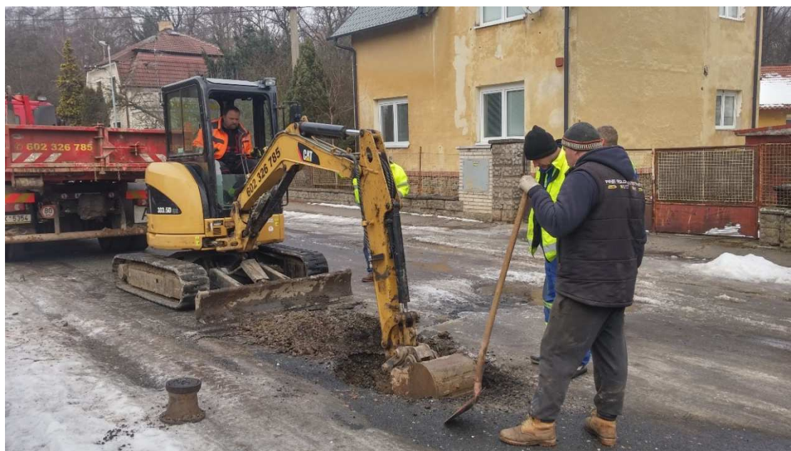
Obr. 3: Havárie na vodovodním řadu
