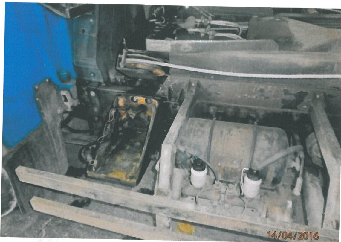
Foto č. 4 Akumulátorový prostor
