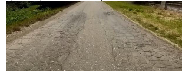
Obrázek 13 - asfaltový povrch s těžkými poruchami
