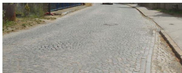
Obrázek 10 - kamenná dlažba se středními poruchami
