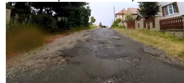
Obrázek 16 - asfaltový poruch v havarijním stavu
