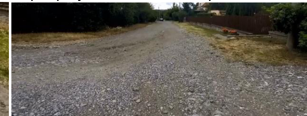
Obrázek 14 - nezpevněný povrch s těžkými poruchami
