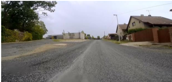
Obrázek 7 - nezpevněný povrch s lehkými poruchami
