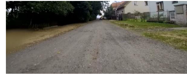
Obrázek 11 - nezpevněný povrch se stř. poruchami
