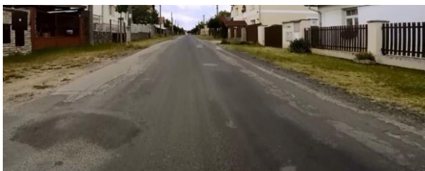
Obrázek 9 - asfaltový povrch se středními poruchami
