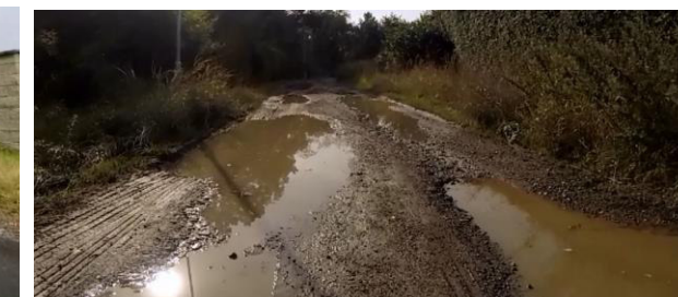
Obrázek 17 - nezpevněný povrch v havarijním stavu
