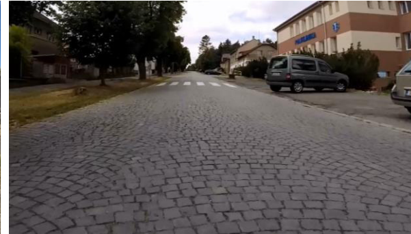
Obrázek 6 – kamenná dlažba s lehkými poruchami
