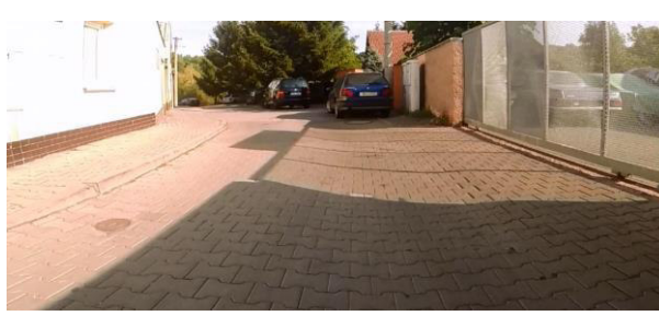
Obrázek 8 - zámková dlažba s lehkými poruchami
