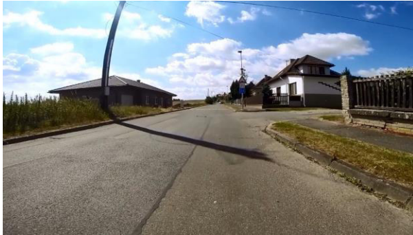
Obrázek 5 - asfaltový povrch s lehkými poruchami
