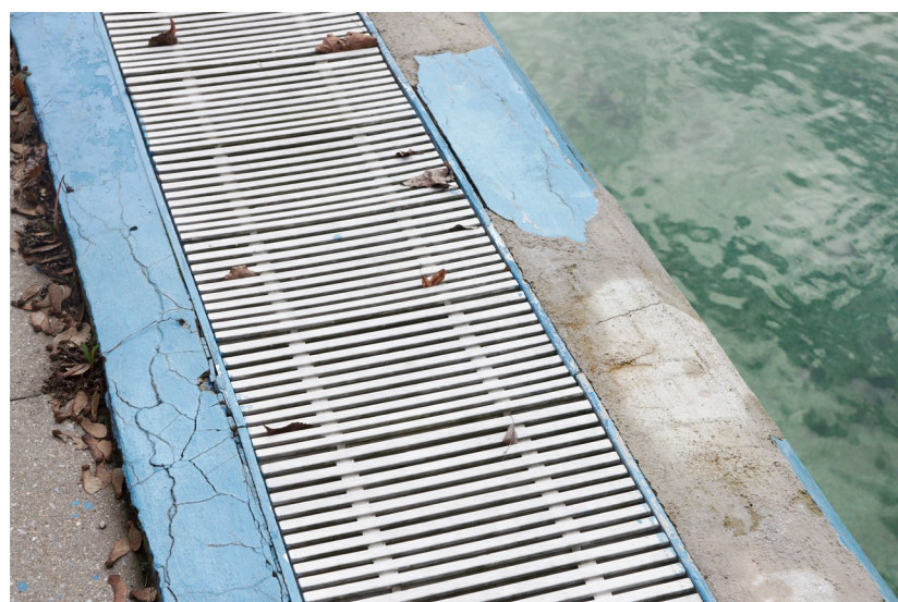
Popraskané hrany horní plochy žlábků
