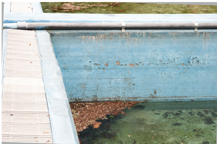
Poničené stěny bazénů
