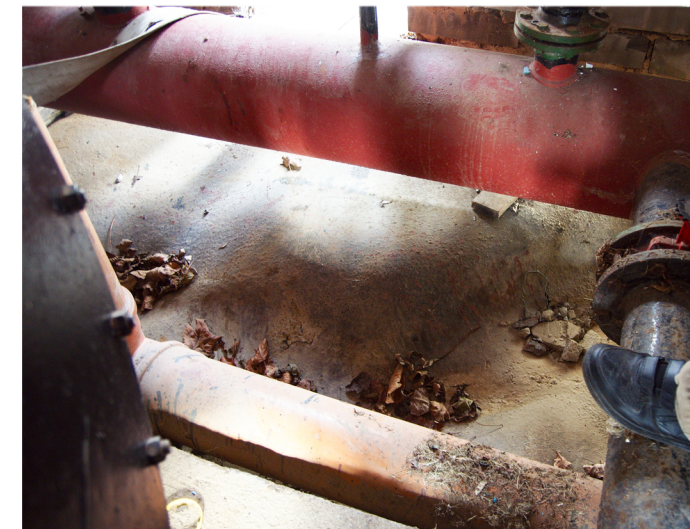
Vyboulená podlaha úpravny vody
