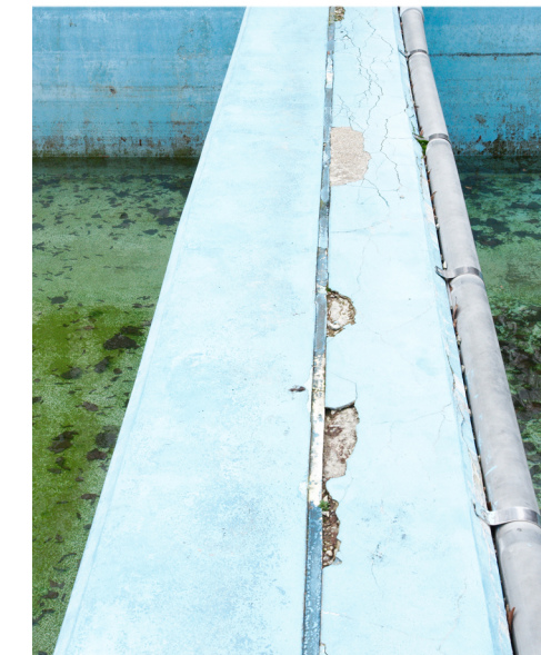
Popraskaná hrana mezi bazény
