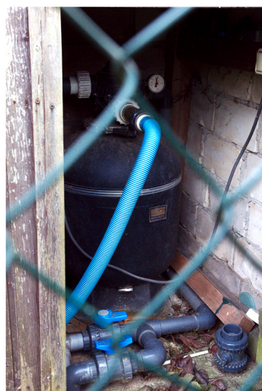
Úpravna dětského bazénu
