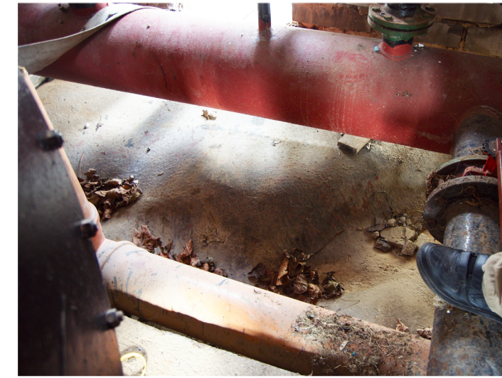
Vyboulená podlaha úpravny vody
