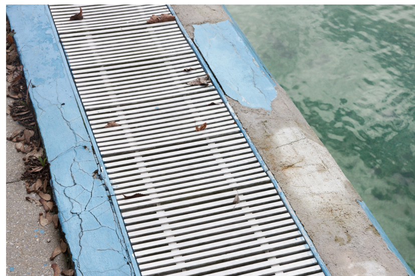
Popraskané hrany horní plochy žlábků
