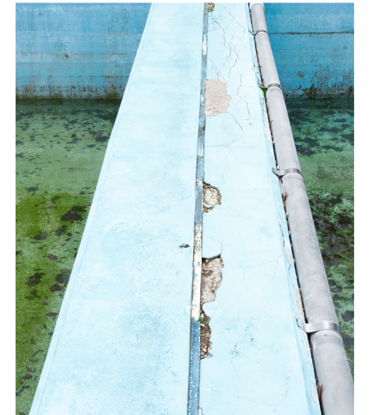
Popraskaná hrana mezi bazény
