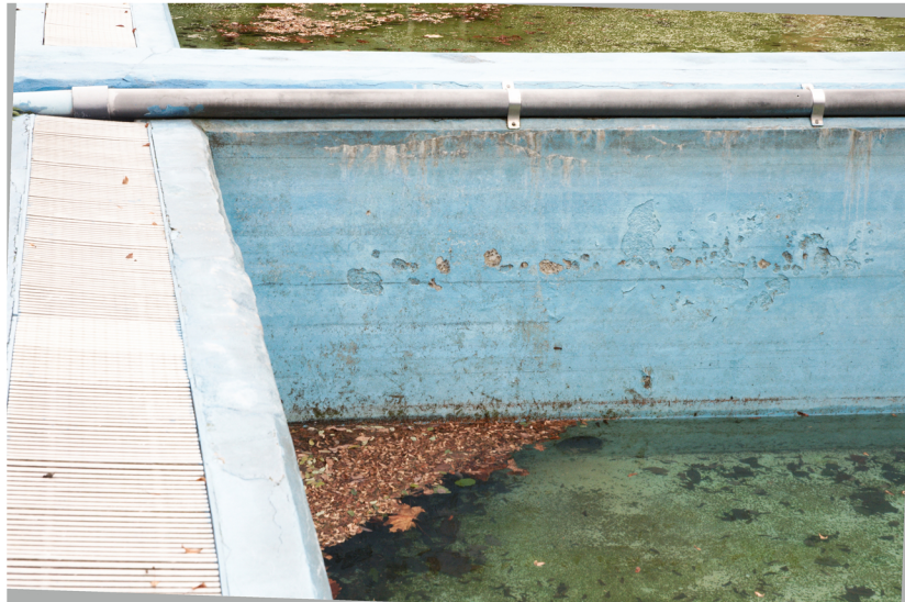
Poničené stěny bazénů
