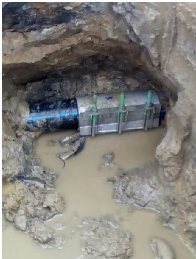
Obr. 4: Porucha na vodovodní přípojce
