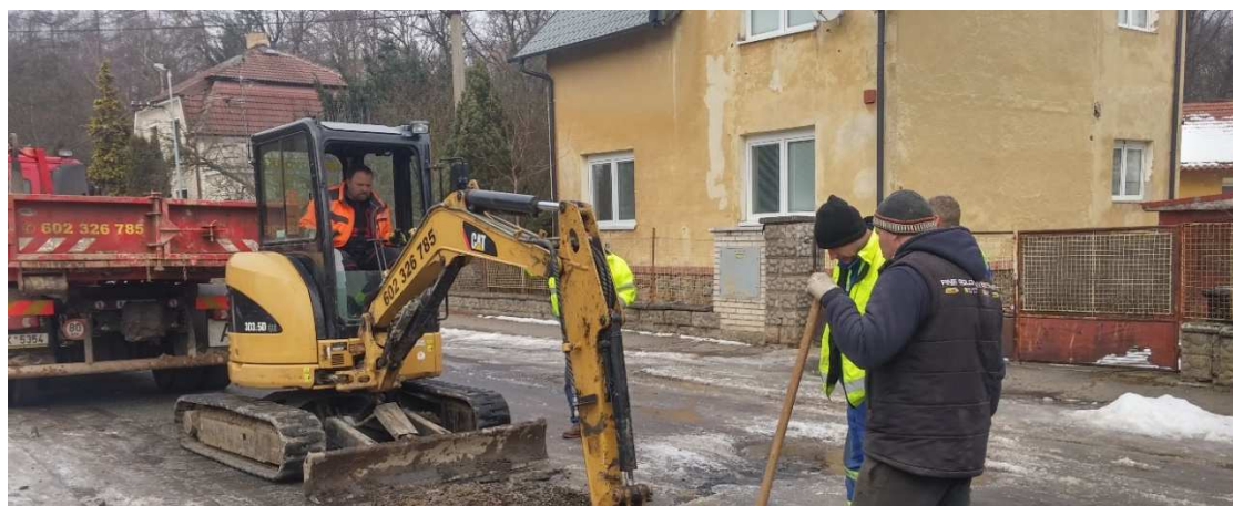
Obr. 3: Havárie na vodovodním řadu
