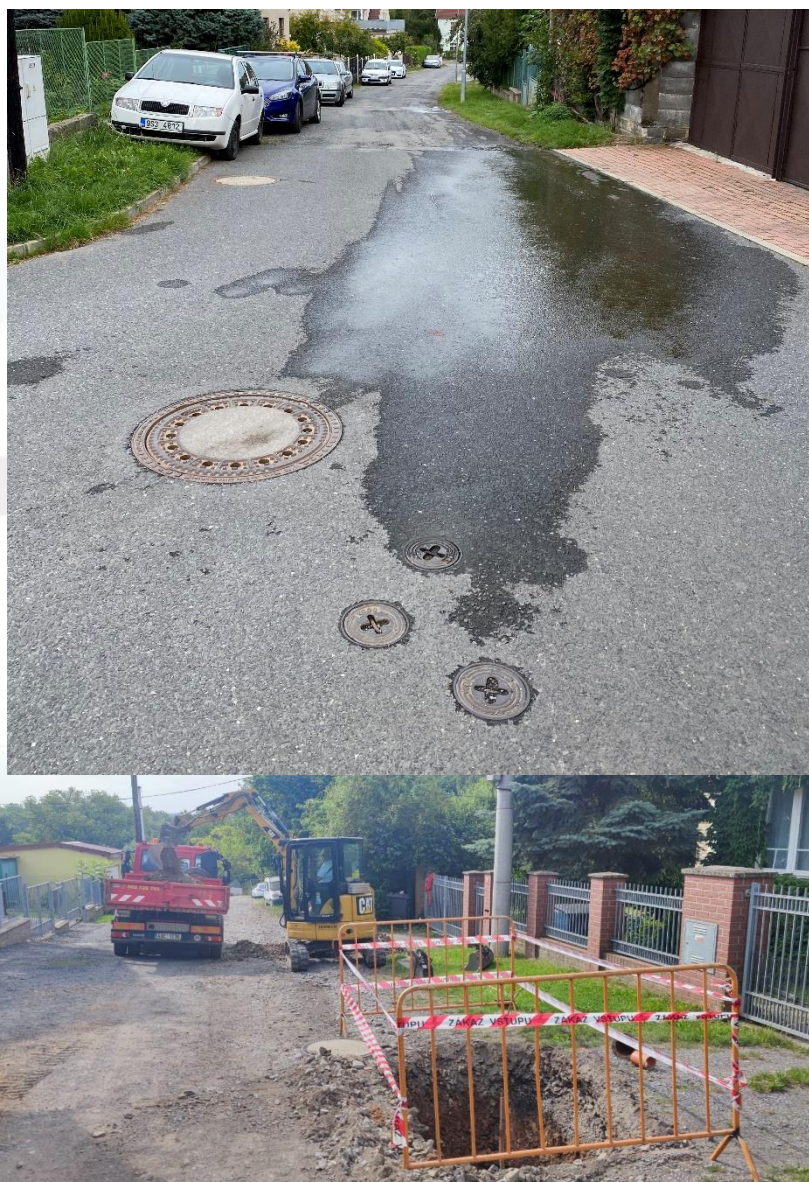
Obr. 5-7: Havárie na vodovodním řadu
