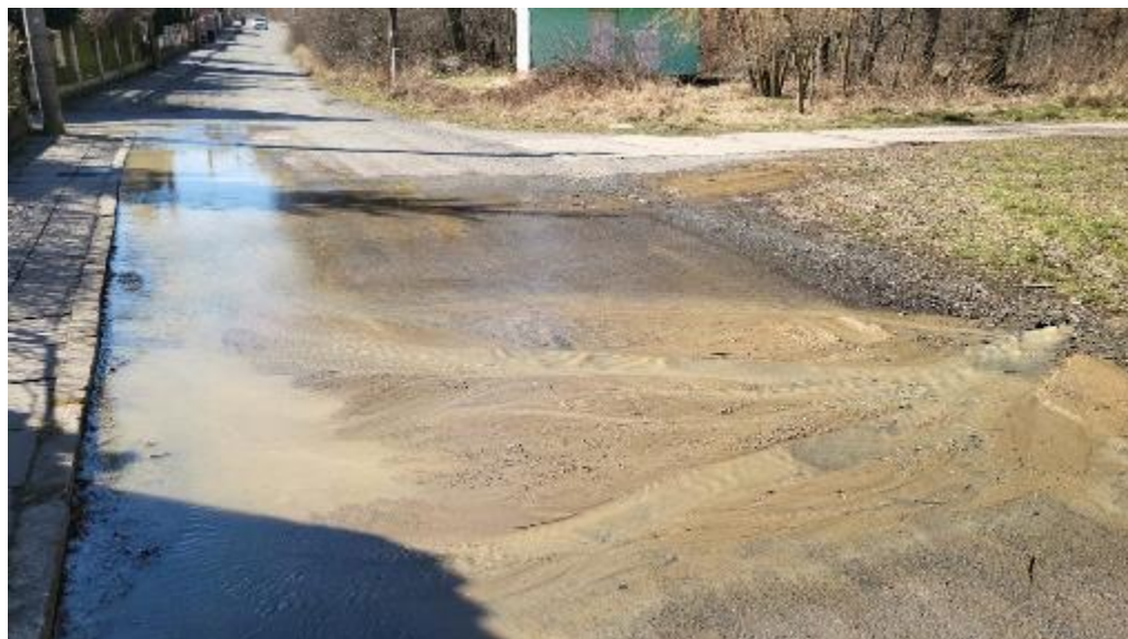
7: Havárie na vodovodním řadu
