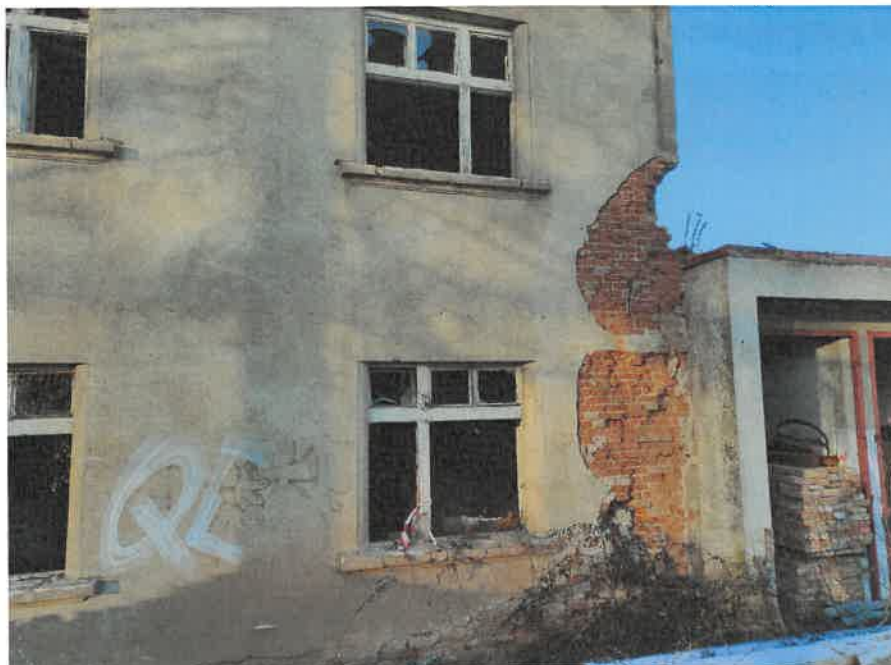
6- na snímku je patrná degradace zdiva
